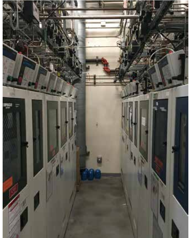
图 2. 半导体制造厂中的气罐机柜 - 无线节点必须在无处不在的金属和重型混凝土结构中可靠运行。
