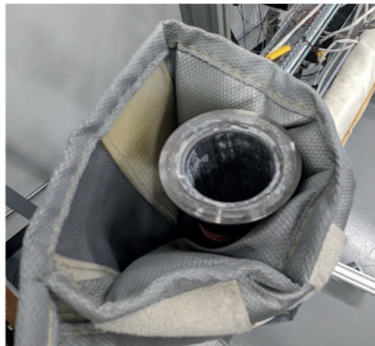
图1：隔热材料松动可能导致多种代价高昂的问题：过热、电力成本增加、停机。监控用电情况可以发现问题，从而采取措施。
